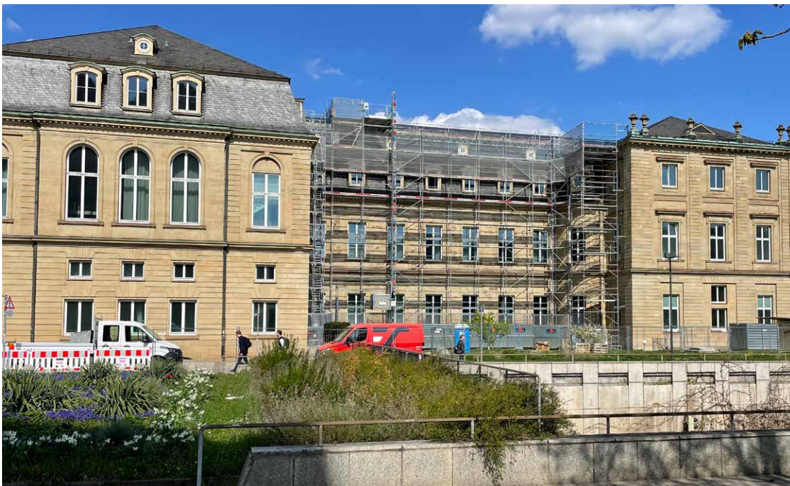
→ Auf dem Dach des Neuen Schlosses befindet sich nun eine PV-Anlage
